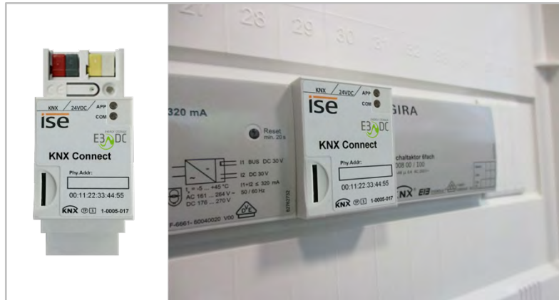
Abb. 1: Verbautes KNX Connect im Installationsverteiler
